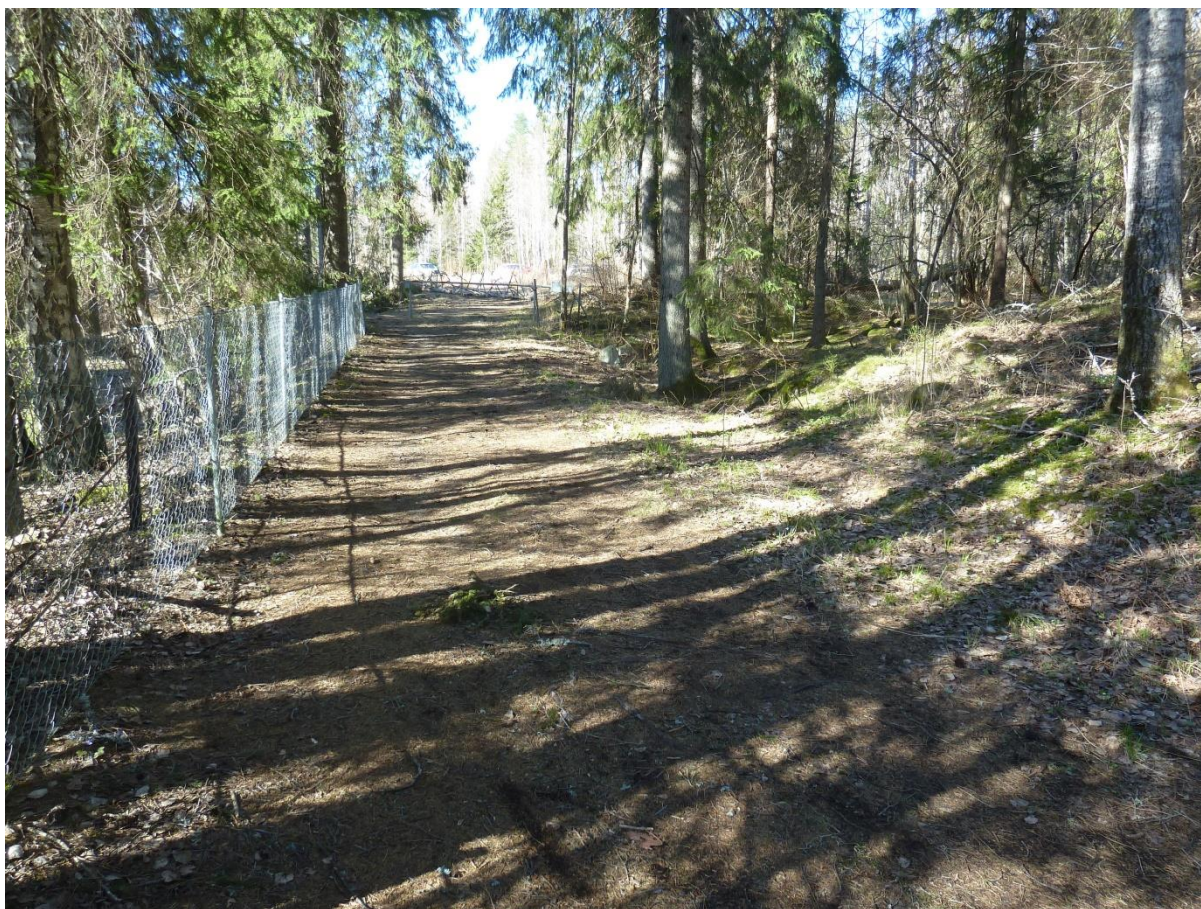
Figur 1- Skogsbilväg från Klackberg till Kolningsbergsvägen (rakt fram). Raset omedelbart till vänster bakom staketet.
