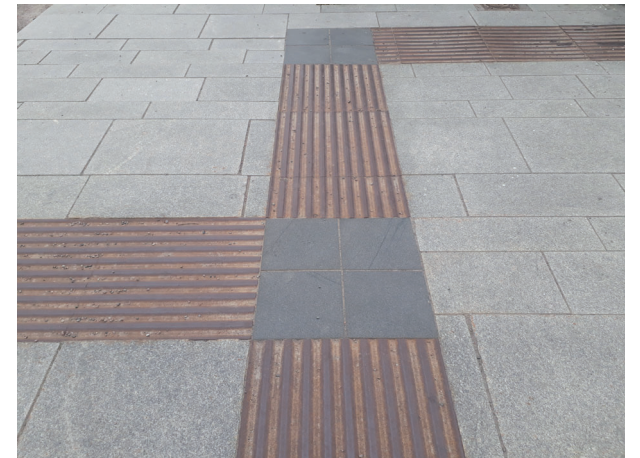
Exempel på ett konstgjort ledstråk i järn och granit. WSP 2022.
