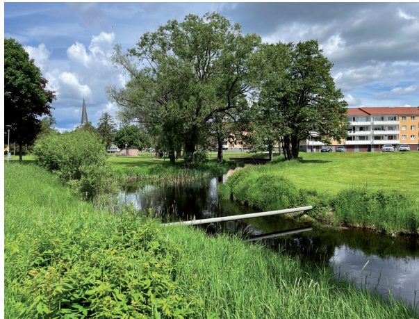
Elledningsrör över ån för energiförsörjning av robotgräsklippare. Det är ett element som påverkar intrycket av området negativt och bör åtgärdas. WSP 2022.
