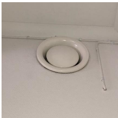
Exempel på frånluftsdon
